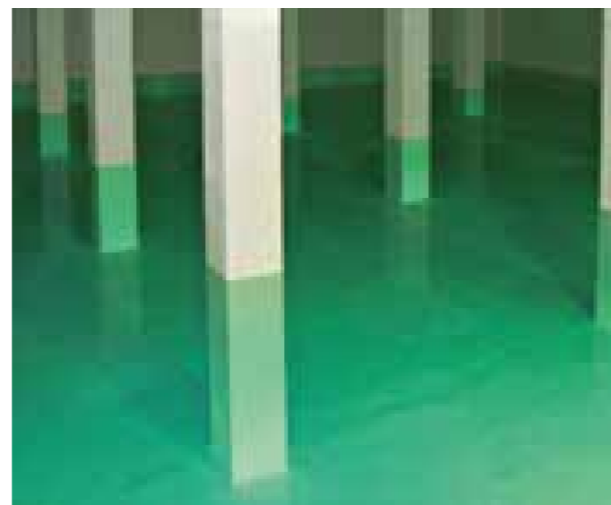
Trinkwasserhochbehälter, Zeilinger Berg
