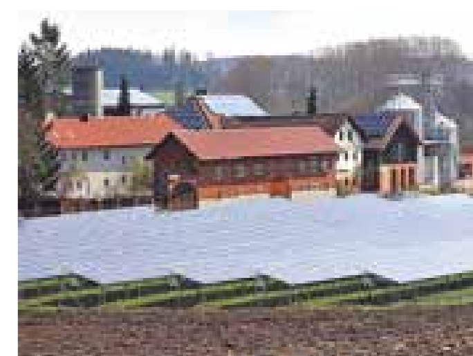
Freiflächen-PV in Kasbach, Gem. Wurmsham
